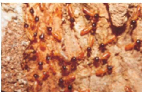
figura 5. Galería abierta de termitas sobre madera
